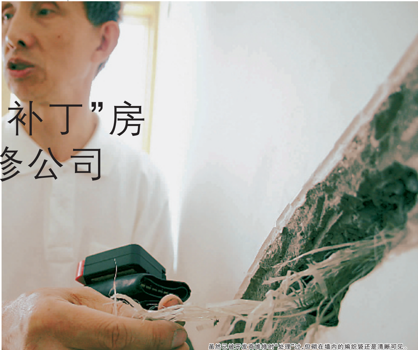
虽然已被开发商维修时“处理”过,但砌在墙内的编织袋还是清晰可见。
